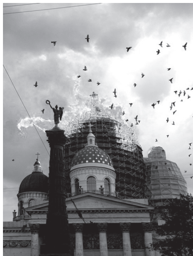
Рис. 1. Пожар Собора (Троицкого) Измайловского полка в Санкт-Петербурге (фото 25.08.2006) Fig. 1. Fire of the Cathedral (Trinity) of the Izmailovsky regiment in St. Petersburg (photo 25.08.2006)
