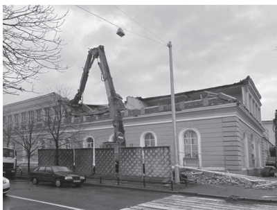
Рис. 2. Разрушение ОНКН манежа лейб-гвардии Финляндского полка на Большом пр. Васильевского острова, Санкт-Петербург (фото В. Егоршина // «Фонтанка.ру») Fig. 2. Destruction of the arena of the Life Guards of the Finland Regiment on Bolshoi Prospekt Vasilievsky Island, Sankt Petersburg
